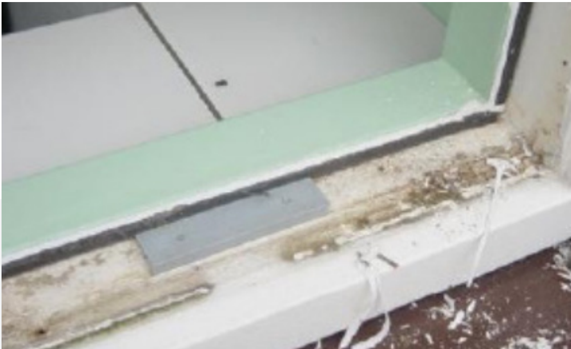
Vervuiling onder de liggende glaslat
